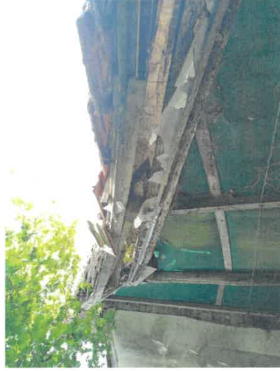
Appentis en mauvais état
