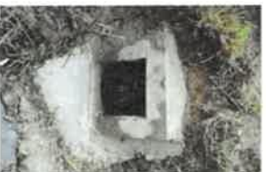
Mise en place d'un clapet anti retour sur le trop plein du poste de relèvement rue du Limousin à Saint Amand Montrond
