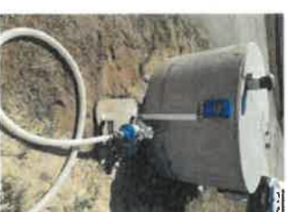
Mise en place d'un débitmètre pour connaître le volume de centrais issus de la déshydratation des boues dites « Covid » à la station d'épuration de Saint Amand Montrond
