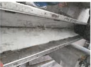
Renouvellement du fond du caisson de la vis sortie de la centrifugeuse à la station d'épuration de Saint Amand Montrond
