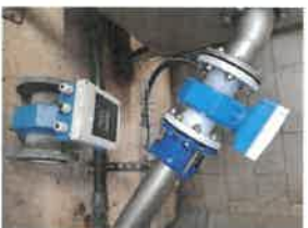
Renouvellement du débitmètre entrée des matières de vidange à la station d'épuration de Saint Amand Montrond
