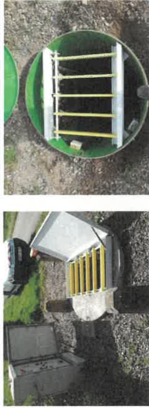
Exemple d'installation d'un barreaudage sur un poste de relèvement
