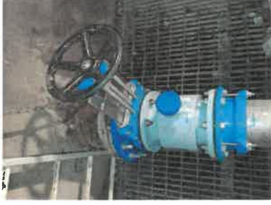
Mise en place d'un débitmètre au poste de relèvement rue de Billeron à Saint Amand Montrond
