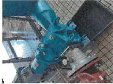
Renouvellement de la pompe en sortie de la centrifugeuse pour évacuer les boues dans les bennes de la station d'épuration de Saint-Amand Montrond
