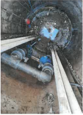
Renouvellement d'un câble anti-retour au poste de relèvement route d'Arbeuilles à Charenton Du Cher
