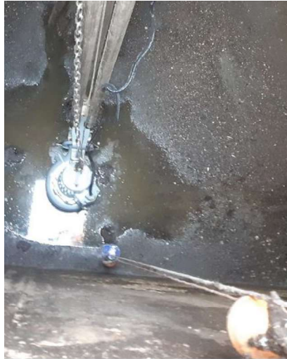
Renouvellement de l'hydro éjecteur dans la fosse des matières de vidange à la station d'épuration de Saint Amand Montrond
