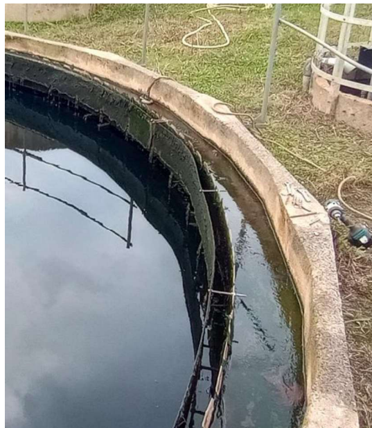
Remplacement des fixations de la cloison siphonide du clarificateur à la station d'épuration d'Orval
