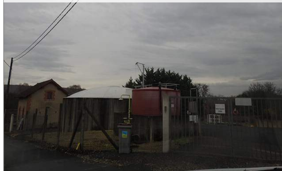
Station d'épuration d'Orval (source : ADEV Environnement)
